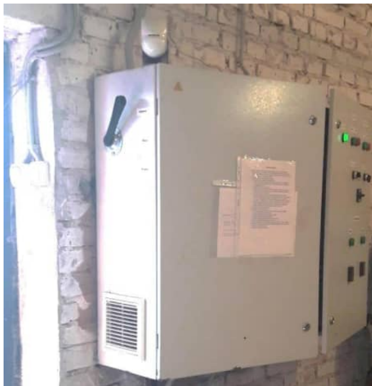
Рис. 4. Щит с передачей сигнала – ВНС района Шагова.
