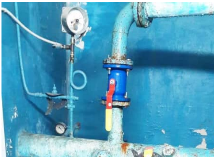
Рис. 2. Арматура и манометр с электрическим выходом - ВНС по ул. Гагарина.
